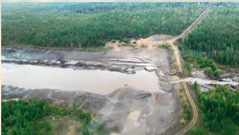
Разрушение дамбы на р. Иртыш (17 августа 2018 г.)
