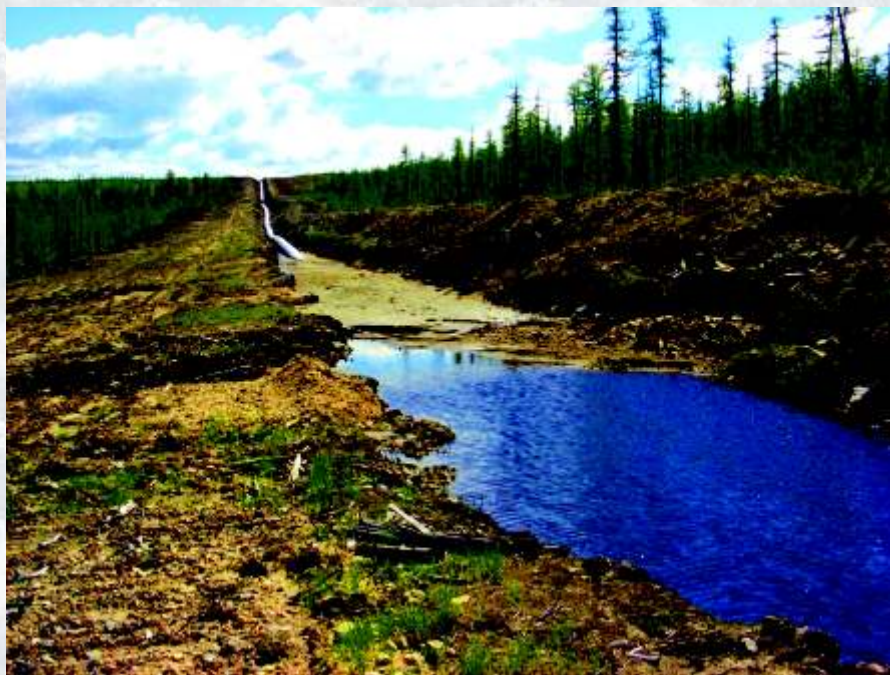
Заплывание трубы при переувлажнении льдонасыщенных грунтов по трассе трубопровода ВС-ТО.
