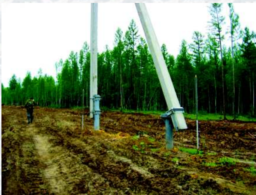
Опоры ЛЭП по трассе ВС-ТО.
