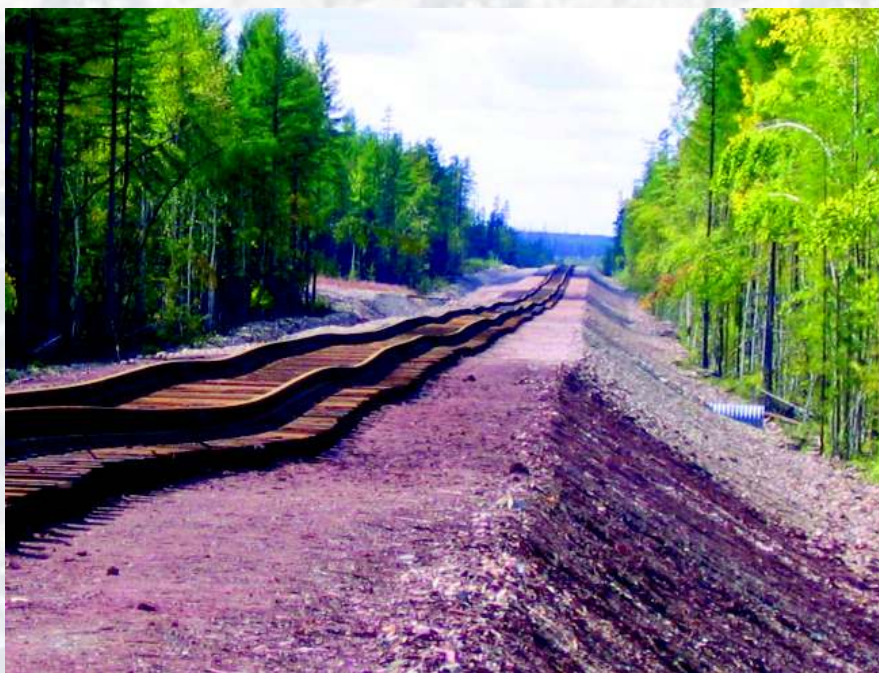
Деформации полотна железной дороги по трассе Томмот – Якутск. Фото Л.А. Гагарина.
