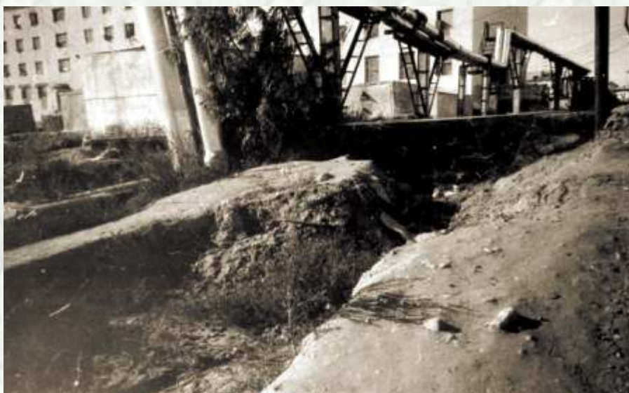
Рис. 1. Активное развитие эрозионных процессов в результате крупных утечек воды из систем теплоснабжения привело к разрушению асфальтовой отсыпки (ул. Губина).
