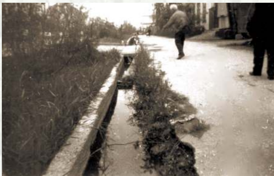
Рис. 2. Деформация и разрушение открытых лотков дождевой канализации в результате развития процессов сезонного пучения-просадки и течения грунтов (ул. Кирова).
