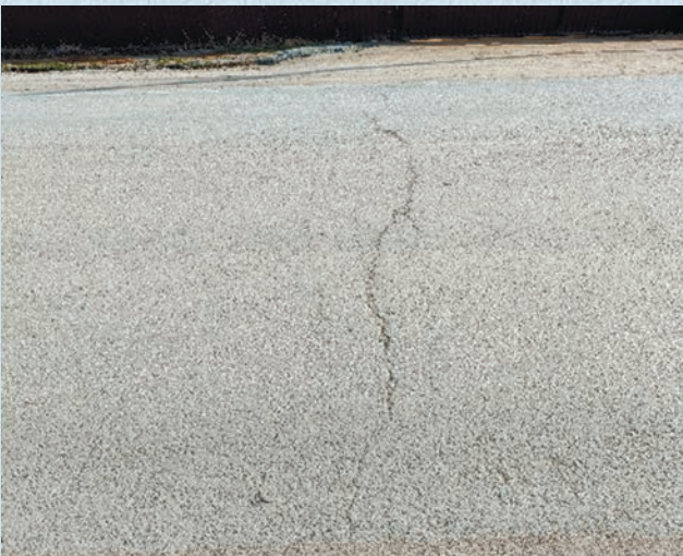
Температурные поперечные трещины дорог в г. Якутске (май 2023 г., ул. Н. Антонова, асфальт 2022 г., частота трещин примерно через каждые 20 м)
