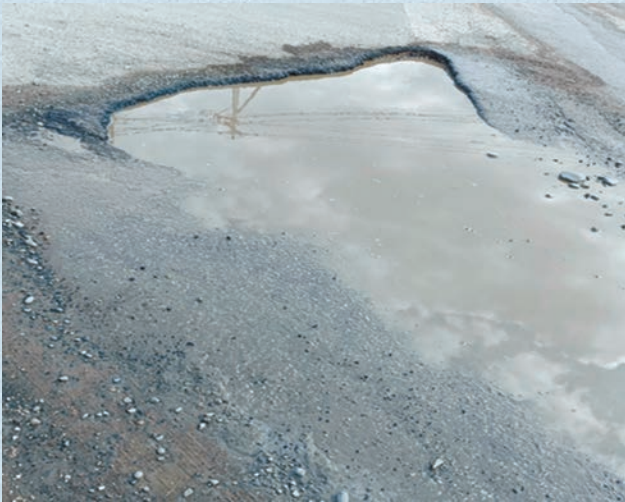
Ямы на асфальтобетоне (г. Якутск, ул. Автодорожная, май 2023 г.)
