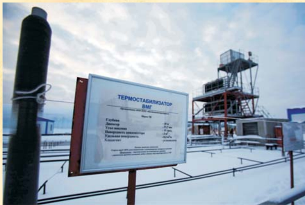
Термостабилизатор ВМГ (слева) и конденсаторный блок, установленные на опытно-промышленном полигоне ООО НПО «Фундаментстройаркос» в пос. Матмасы. Фото А. А. Павлычева.
